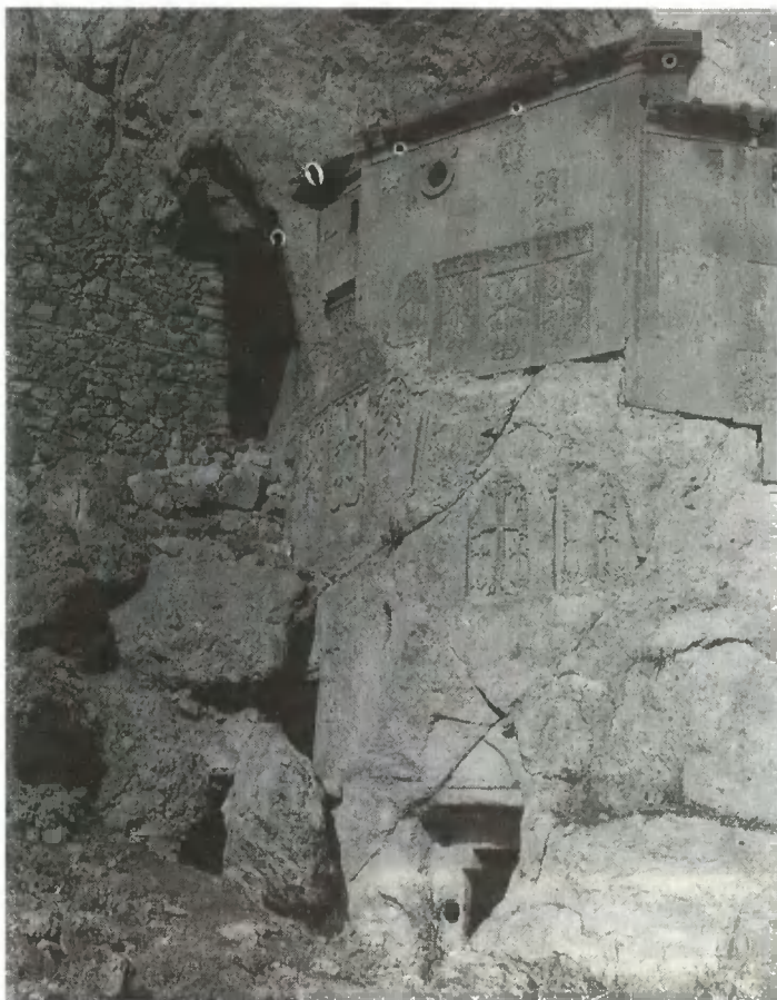
Гегардский монастырь (XIII в.), вырубленный в базальтах. Видны следы землетрясения (трещины и завал входных проемов).
